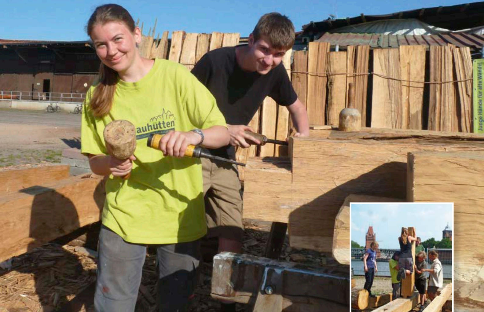
Wie im Mittelalter: Freiwillige der Jugendbauhütte Lübeck bereiten die Rekonstruktion eines historischen Holzkellers vor.
